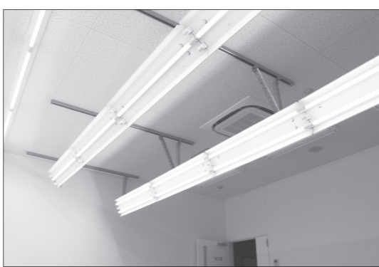
設置例:印刷校正室
