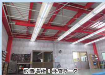
設置場所: 検査ブース エーモン工業株式会社様
